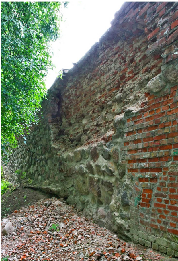
Fot.01. Stan muru w 2008 roku.
