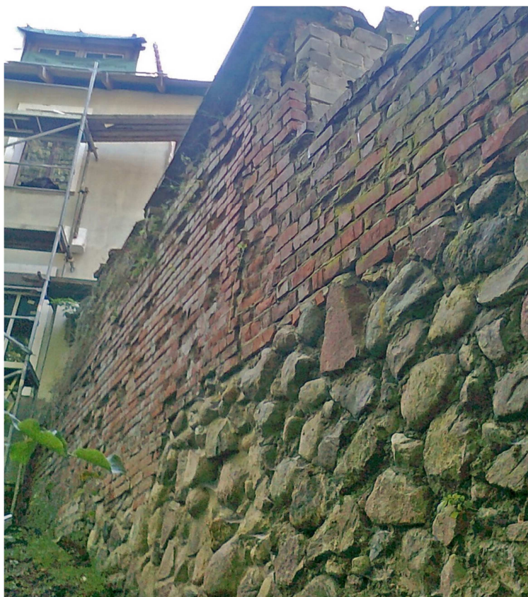
Fot.05. Stan muru we wrześniu 2015 roku.
