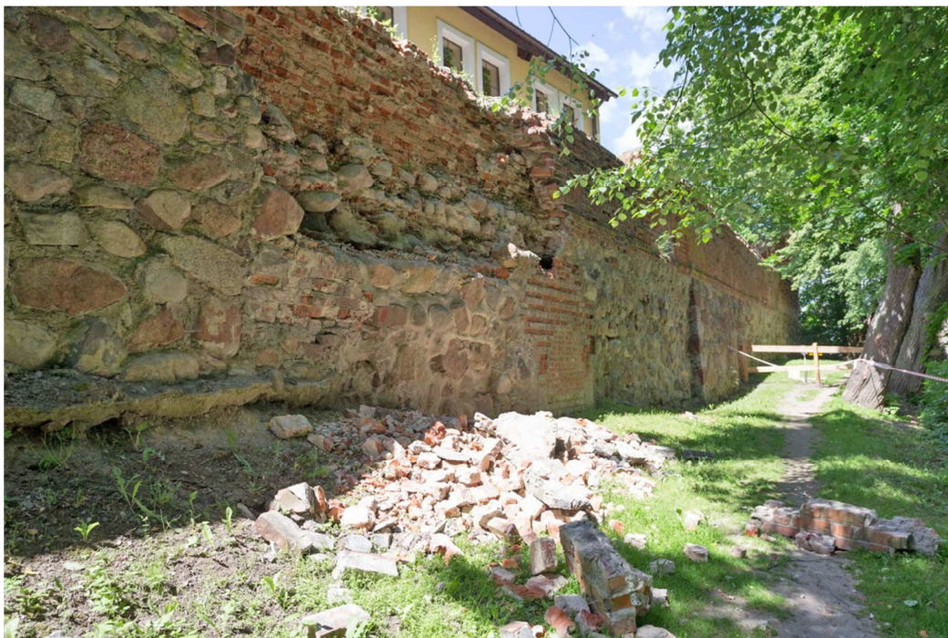
Fot.07. Stan muru po awarii w czerwcu 2017 roku.
