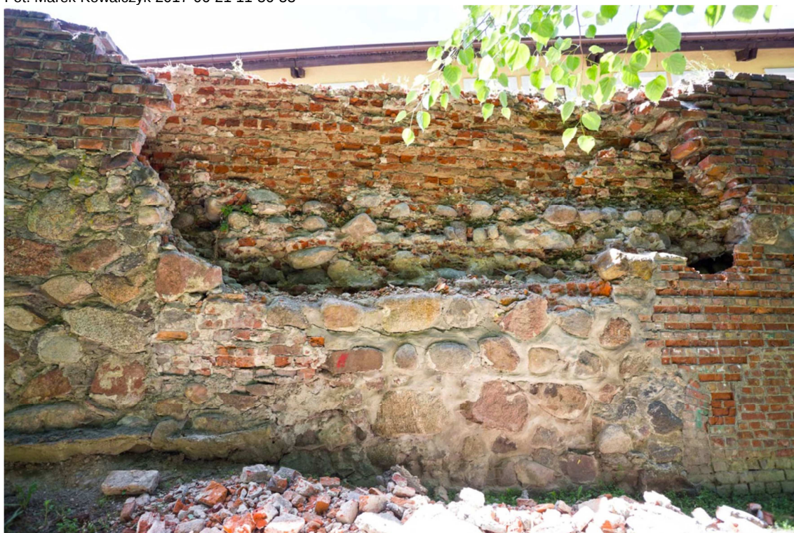
Fot.10. Stan muru po awarii w czerwcu 2017 roku. Rozległy ubytek.
