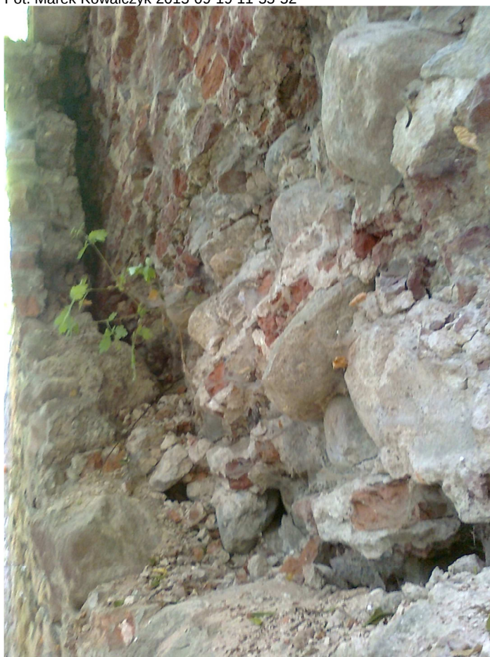
Fot.06. Rozwarstwienie muru we wrześniu 2015 roku.
