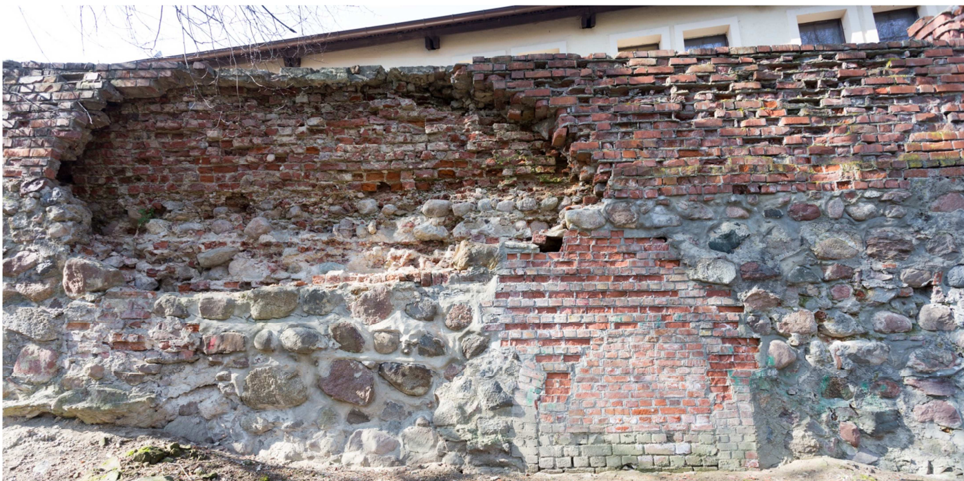
Fot.02. Stan muru w 2015 roku – niewielki przyrost ubytków.
