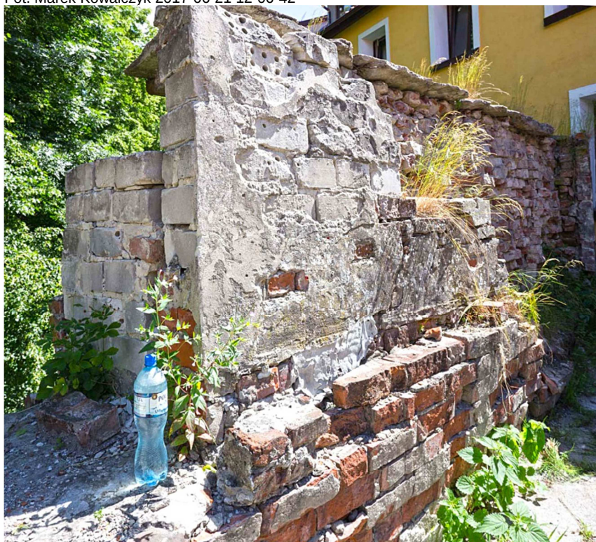
Fot.12. Stan muru w czerwcu 2017 roku – odcinek przy domu parafialnym.
