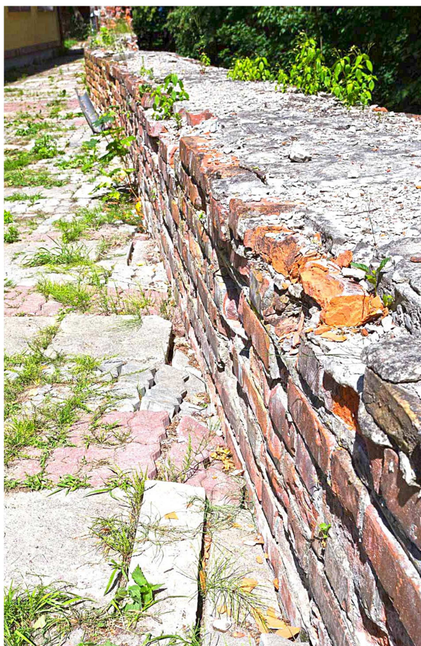
Fot.13. Stan muru w czerwcu 2017 roku – zapadnięcie nawierzchni przy murze.
