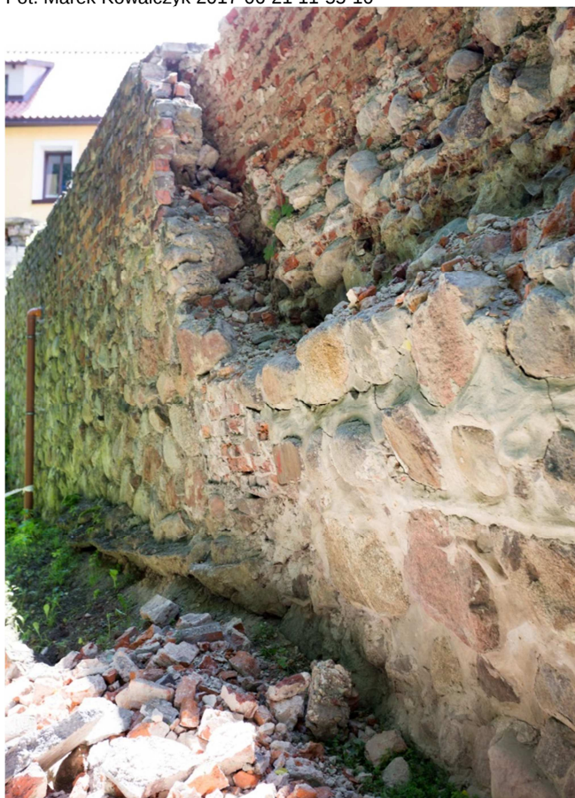
Fot.08. Stan muru po awarii w czerwcu 2017 roku. Znaczny ubytek i poszerzenie szczeliny.
