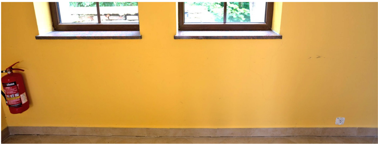
Fot.17. Budynek oratorium – zapadnięcie posadzki od strony muru obronnego.
