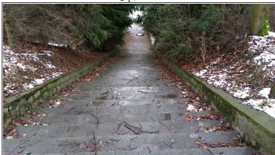
Betonowe schody prowadzące na wzniesienie (skarpe) za szkołą - do rozbiórki w całości, łącznie z murkami. Drzewa po obu stronach do wycinki.
