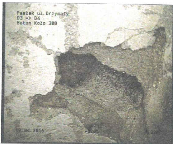
Zdjęcie: 4_6A 4,24m, Brakująca ściana, od 1 do 3 godz.
