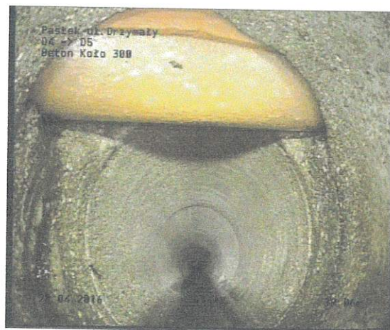
Zdjęcie: 6_11A 39,5m, Zewnętrzne przewody lub kable przechodzące przez rurociąg, Zmniejszenie powierzchni przekroju poprzecznego: 15 %, od 10 do 2 godz.
