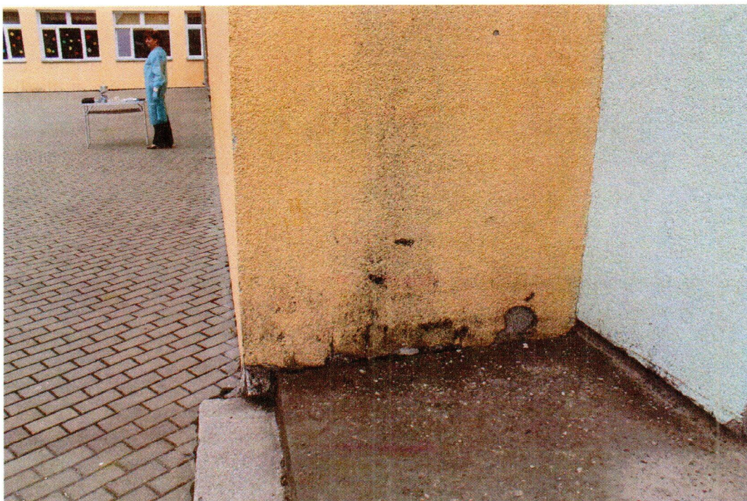
Fot.5. Ubytki w dociepleniu sali gimnastycznej – zawilgocone schody i materiał docieplający
