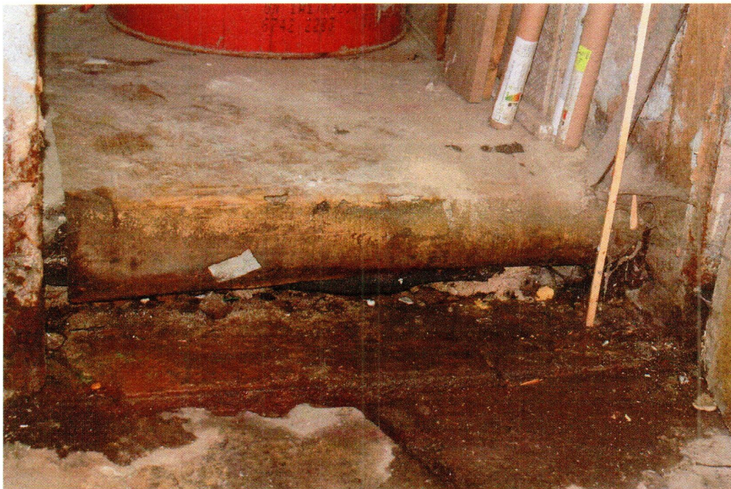
Fot. 11. Kotłownia – ubytki w wylewce betonowej, wyciekająca woda
