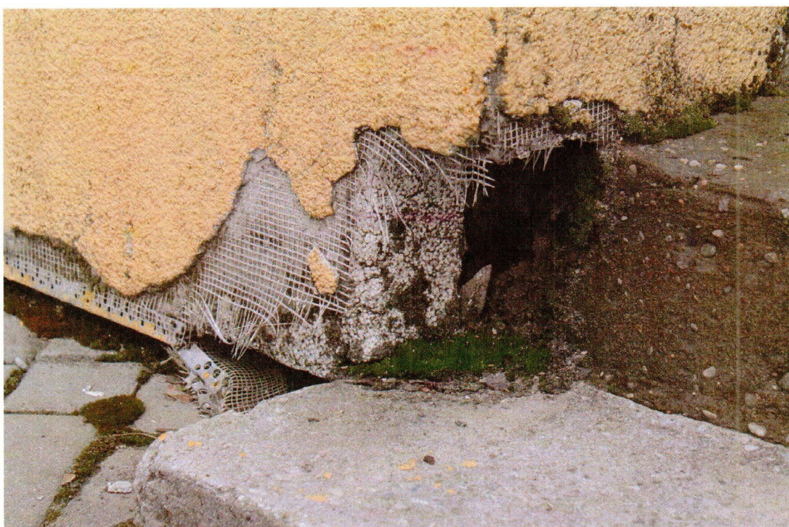
Fot.6. Zawilgocone schody i materiał docieplający – wejście do sali gimnastycznej od strony magazynku
