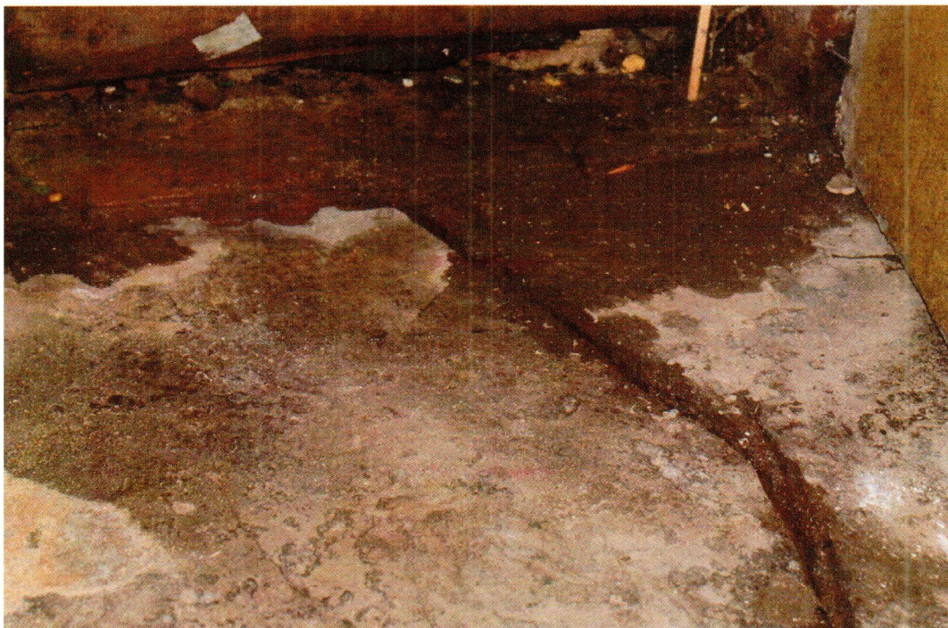
Fot. 12. Spękana i mokra wylewka betonowa w pomieszczeniu kotłowni
