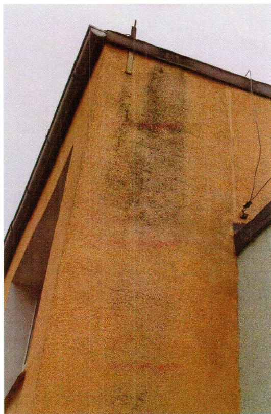
Fot. 4. Ściana od strony magazynku z wyraźnymi oznakami zawilgocenia – ściana mokra na całej wysokości
