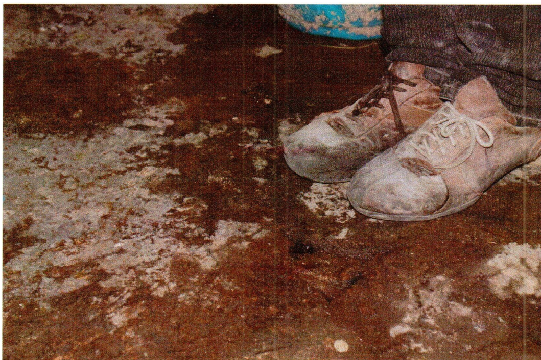
Fot. 14. Mokra wylewka betonowa w pomieszczeniu konserwatora – podczas chodzenia beton ugina się pod ciężarem ciała i na powierzchnię posadzki wydobywa się woda
